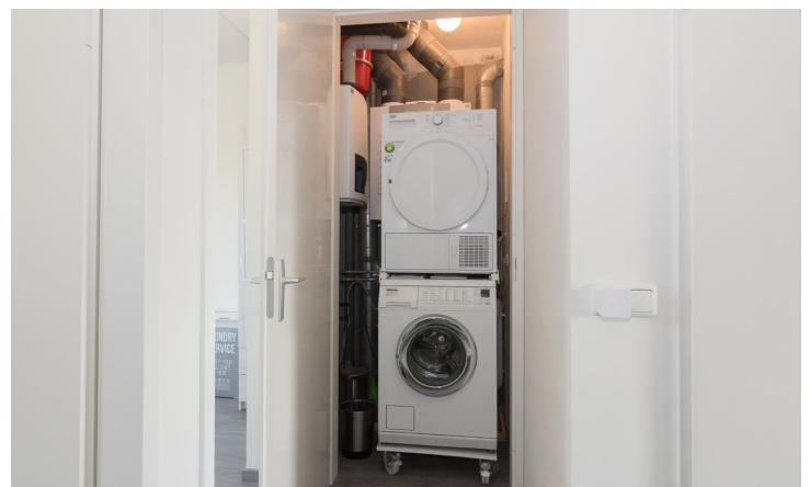
technische ruimte met witgoed aansluitingen
